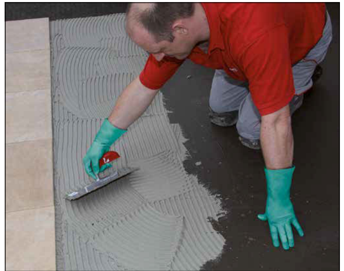
16 Auftragen des zweikomponentigen Flexklebers Sopro megaFlex S2 oder Sopro megaFlex S2 turbo auf die ausgehärtete Abdichtung.
